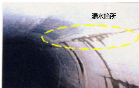
写真-1 児玉幹線トンネルの漏水状況
