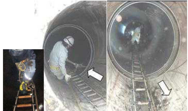
写真6 電動ウィンチによる管吊り下ろし (管内) (左) 親綱への安全帯連結状況 (安全対策)
